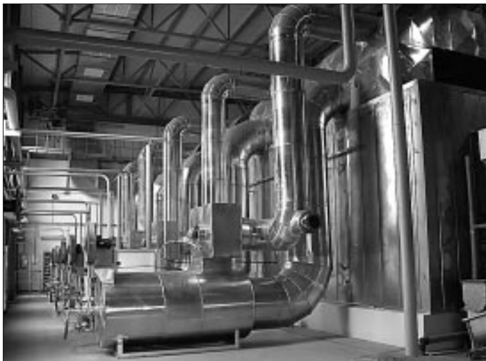
Сушка осадка на низкотемпературных ленточных сушильных установках фирмы «KLEIN» (Германия).
