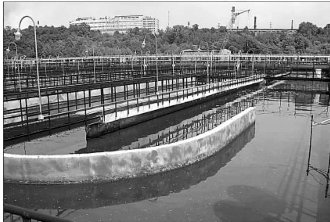
Аэротенки блока № 3, заполненные сточными водами.
